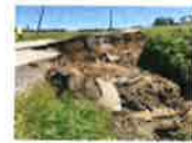
June, 2014 CSAH 6 flood damage
